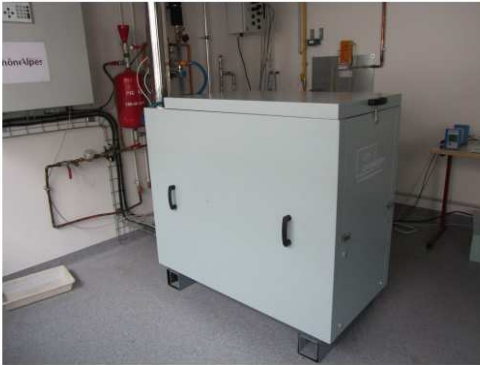
Figure 1 : photo de la cogénération
